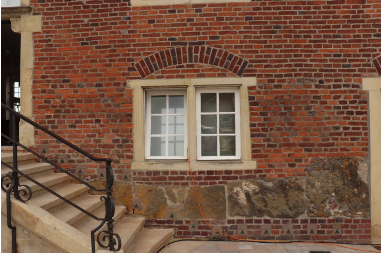
Abb. 27: Velen-Ramsdorf, Burgplatz Ramsdorf (MKZ 4107,0525); Foto des Fensters aus der Renaissance im unteren Geschoss. Deutlich ist die darunter befindliche Erneuerung der Mauer mit den nur in dieser Phase in der Burg verwendeten Backsteinen erkennbar (Foto: Salisbury Archäologie GmbH, G. V. Grimm).
