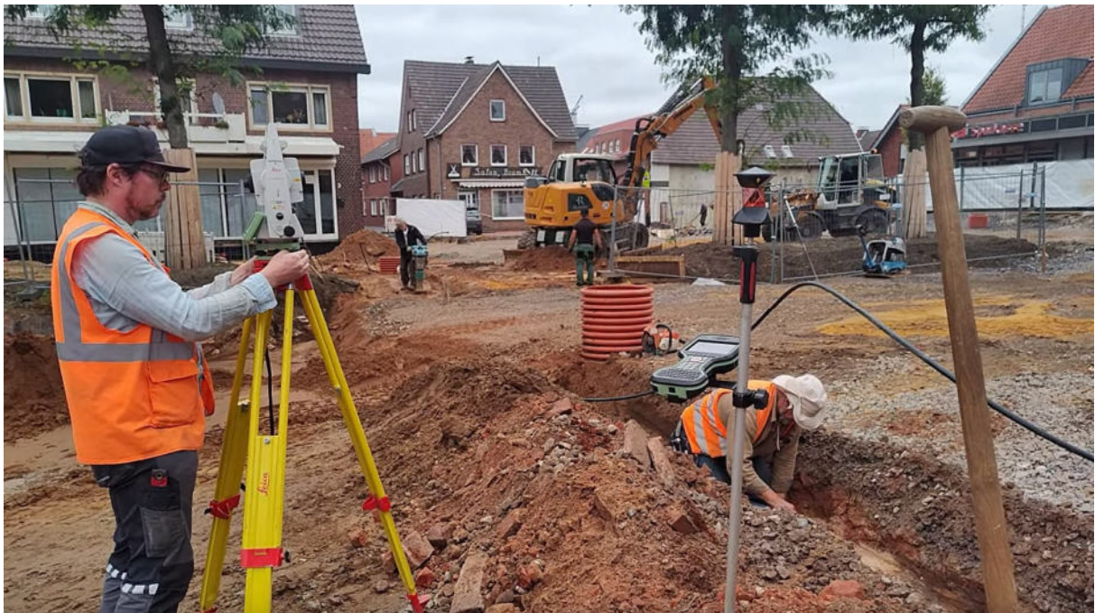
Abb. 10: Velen-Ramsdorf, Burgplatz Ramsdorf (MKZ 4107,0525); Arbeiten in Schnitt 12 (Rohrgraben) (Foto: Salisbury Archäologie GmbH, S. Deiters).
