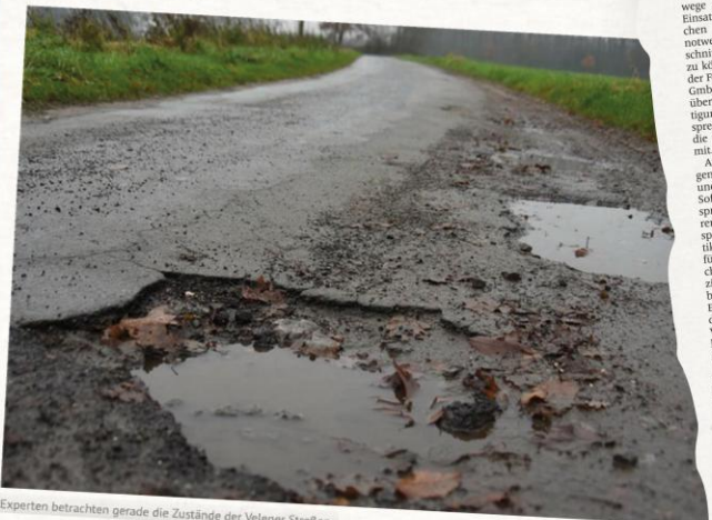
Experten betrachten gerade die Zustände der Velener Straßen.
