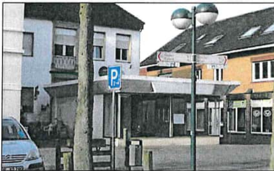
Fassaden mit Gestaltungs- und Erneuerungsbedarf in den Ortskernen der Stadt Velen
