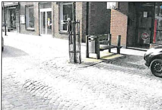
Einbauten in der Lange Straße als "Hinder- nis" für Fußgänger und Radfahrer, Mängel in der Oberfläche
